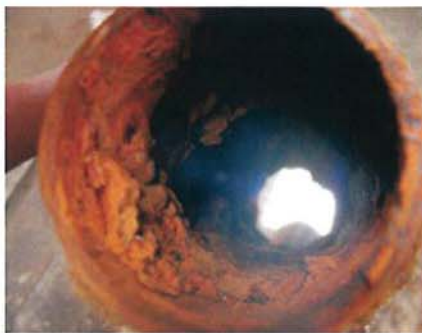
Galvaniserade kallvattenrör innan Bauer vattenbehandling har installerats
