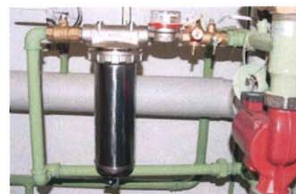
Filtrering över pumpen
