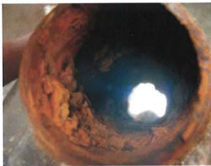
Galvaniserade kallvattenrör innan Bauer vattenbehandling har installerats
